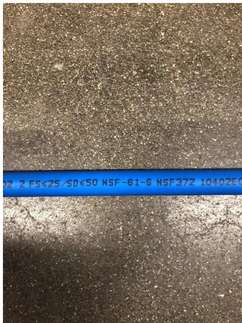
Tubería de agua potable PEX azul con etiqueta NSF
